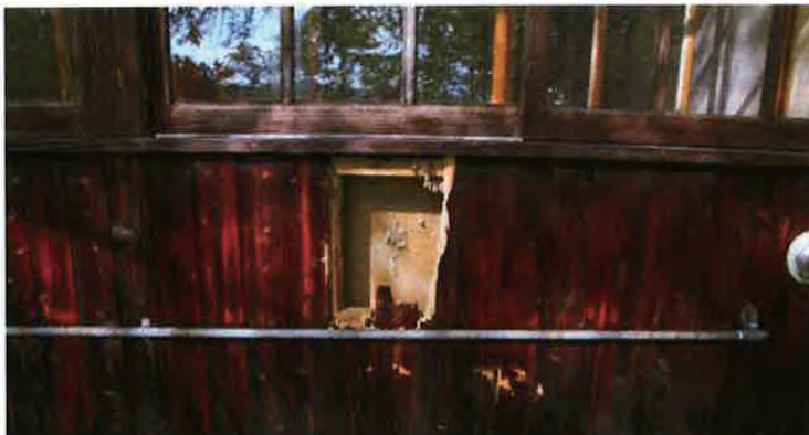
図 1-44 クマによる外壁の破壊
